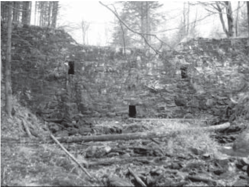
Fot. 1. Zapora/stanowisko 4 w korycie Černego Potoku The check dams in the Černý Potok channel at site 4
